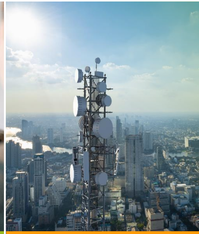
通訊基礎設施
